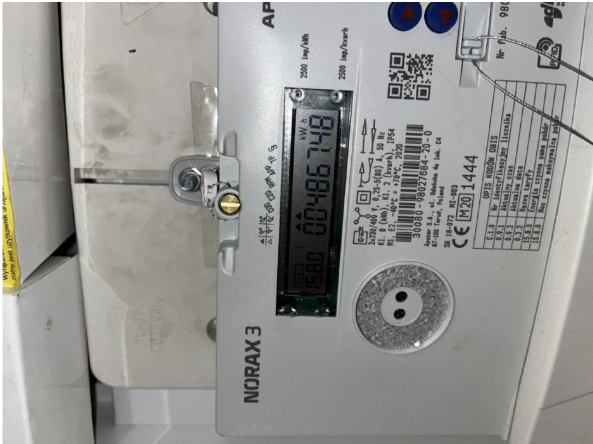
Zdjęcia licznika Energia elektryczna
