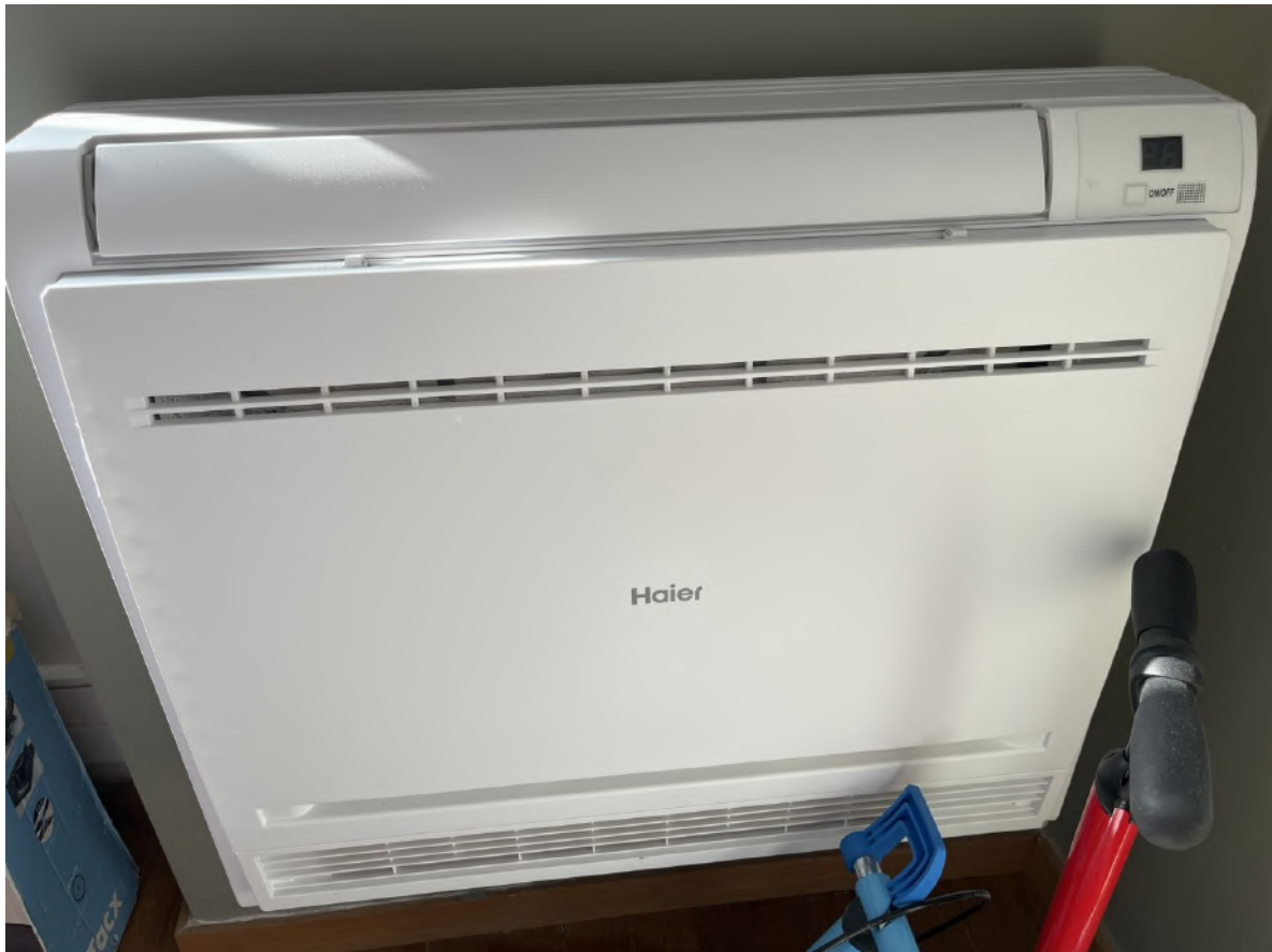
Zdjęcie. Klimatyzacja położony w Całe mieszkanie
