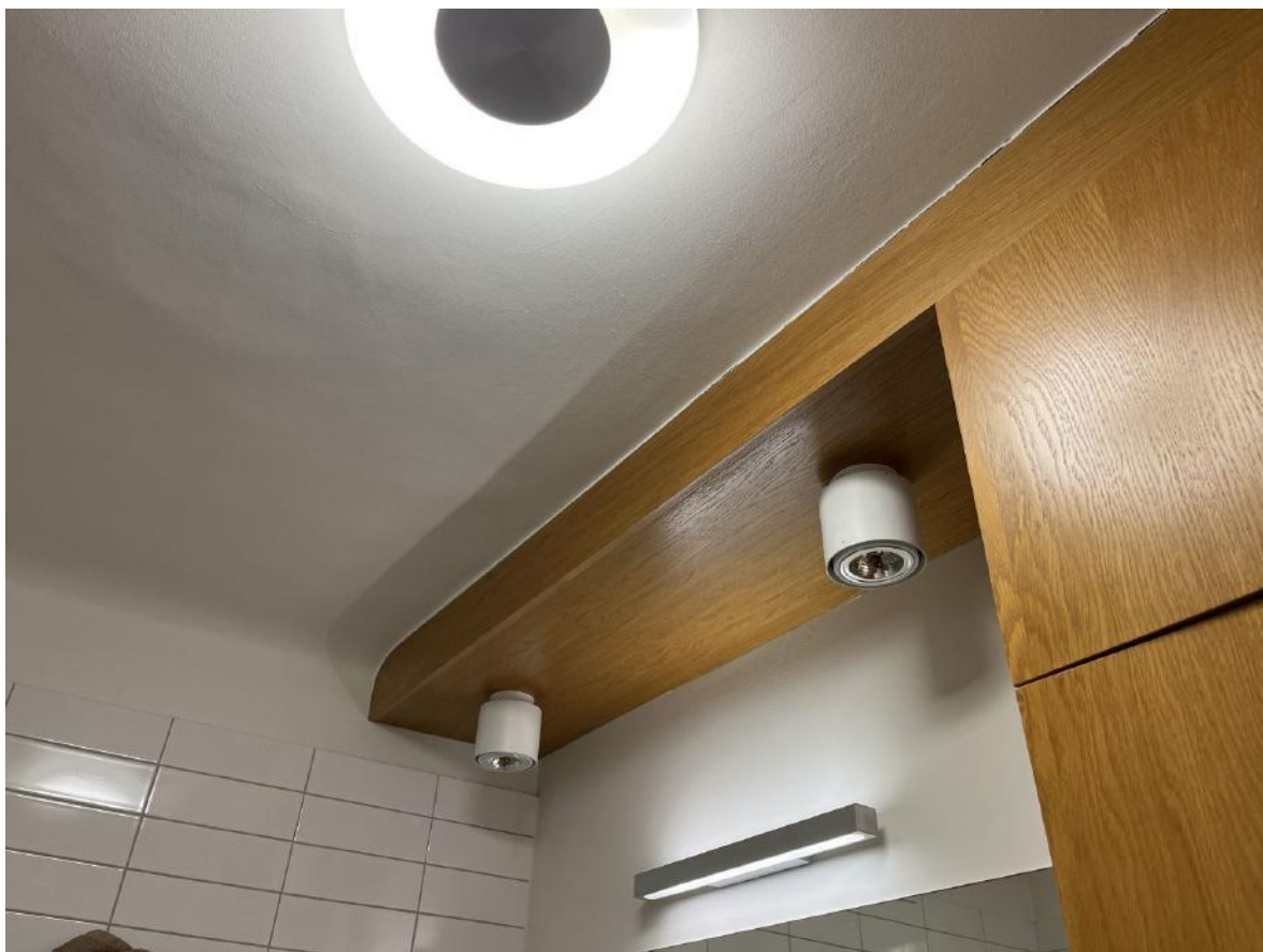
Zdjęcie. Lampy ścienne/sufitowe położony w łazienka
