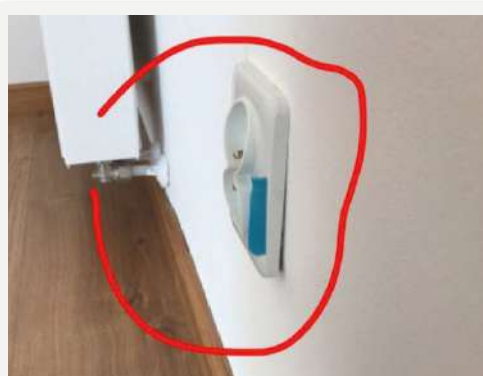
źle zamontowane gniazdko
