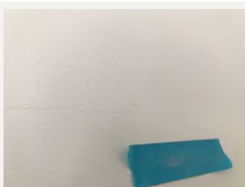
rysa na tynku
