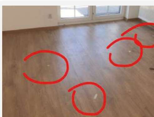
uszkodzenia mechaniczne paneli
